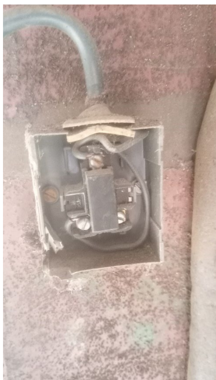
Obr. č. 8 – Poškozený kryt vypínače
