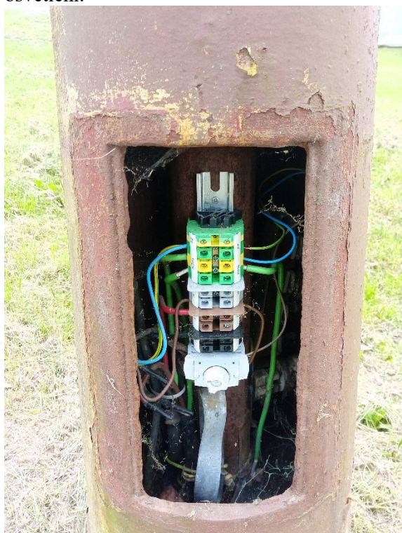
Obr. č. 6 – Odkrytá svorkovnice lampy veřejného osvětlení.
