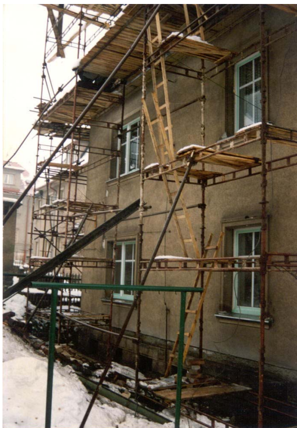
Obr. 4: Lešení dílcové „HAKI“ kombinované s trubkovým lešením vykazující hrubé konstrukční závady a bezpečnostní nedostatky (chybí úhlopříčné podélné ztužení, vřpěry nejsou provedeny v souladu s normou, výstupní žebříky neodpovídají normovým požadavkům, chybí ochranné zábradlí se zarážkou u podlahy)
