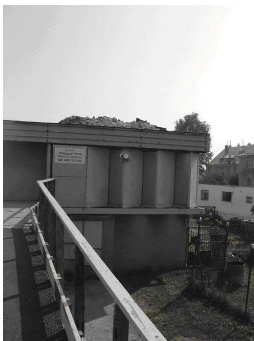
Obr. 1: Nezajištěné pracoviště při práci ve výšce
