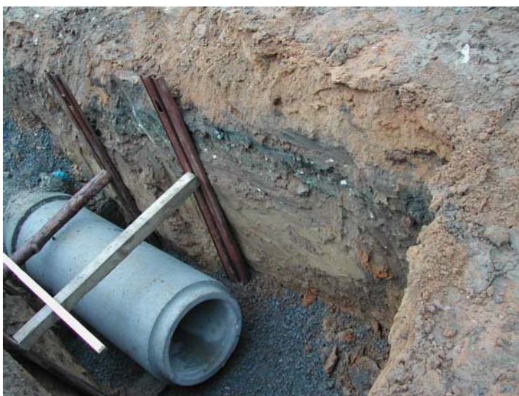
Obr. 9: Nezapažený výkop, do kterého vstupují pracovníci
