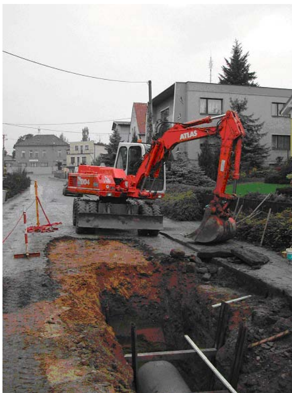
Obr. 8: Výkop bez pažení, výkopy provedené bez zásad pažení, které nebyly stanoveny v projektu
