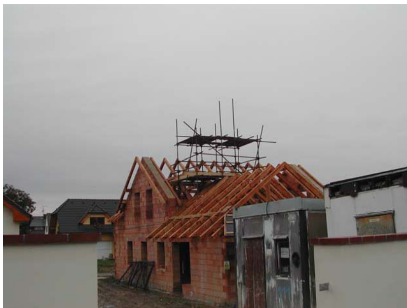
Obr. 2: Nedostatečně vybavené prostorové lešení
