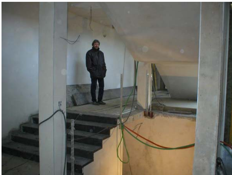
Obr. 7: Místa práce ve výšce nejsou bezpečně přístupná, u schodiště chybí zábradlí
