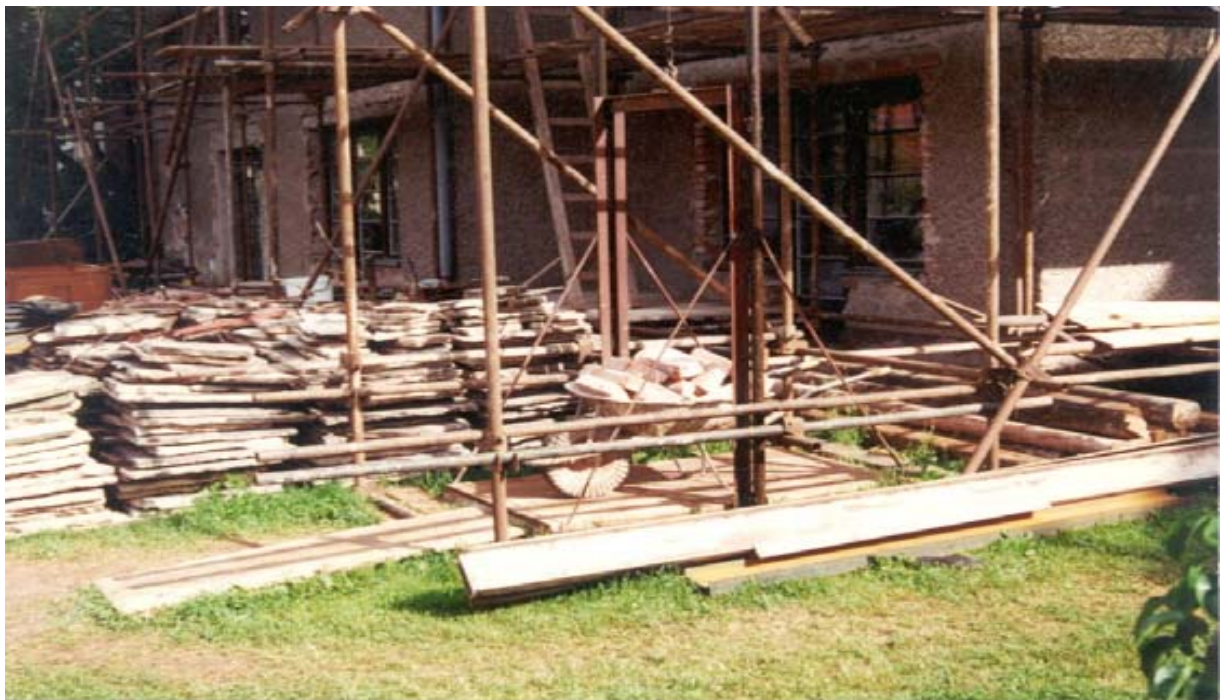
Obr. 10: Výtah – tzv. „plošina na jedno kolečko“ – neprovedeno úhlopříčné ztužení konstrukce výtahové věže, neprovedeno ohrazení konstrukce výtahové věže, výtahová plošina není ohrazena do výše 1,1 m, není vyznačena nosnost a zákaz jízdy osob
